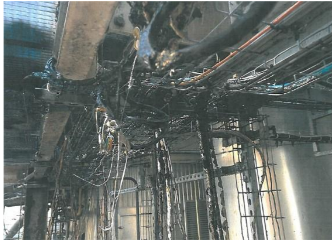
Chemins de câbles calcinés suite à un incendie d'origine électrique
